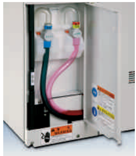
Hinter einer Abdeckung an der rechten Stirnseite der 35er: die Altkemie-Ablaufhähne.
